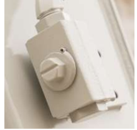
Rubinetti apri/chiedi all'uscita dell'impianto ausiliario per evitare spillamenti e perdite di pressione.
